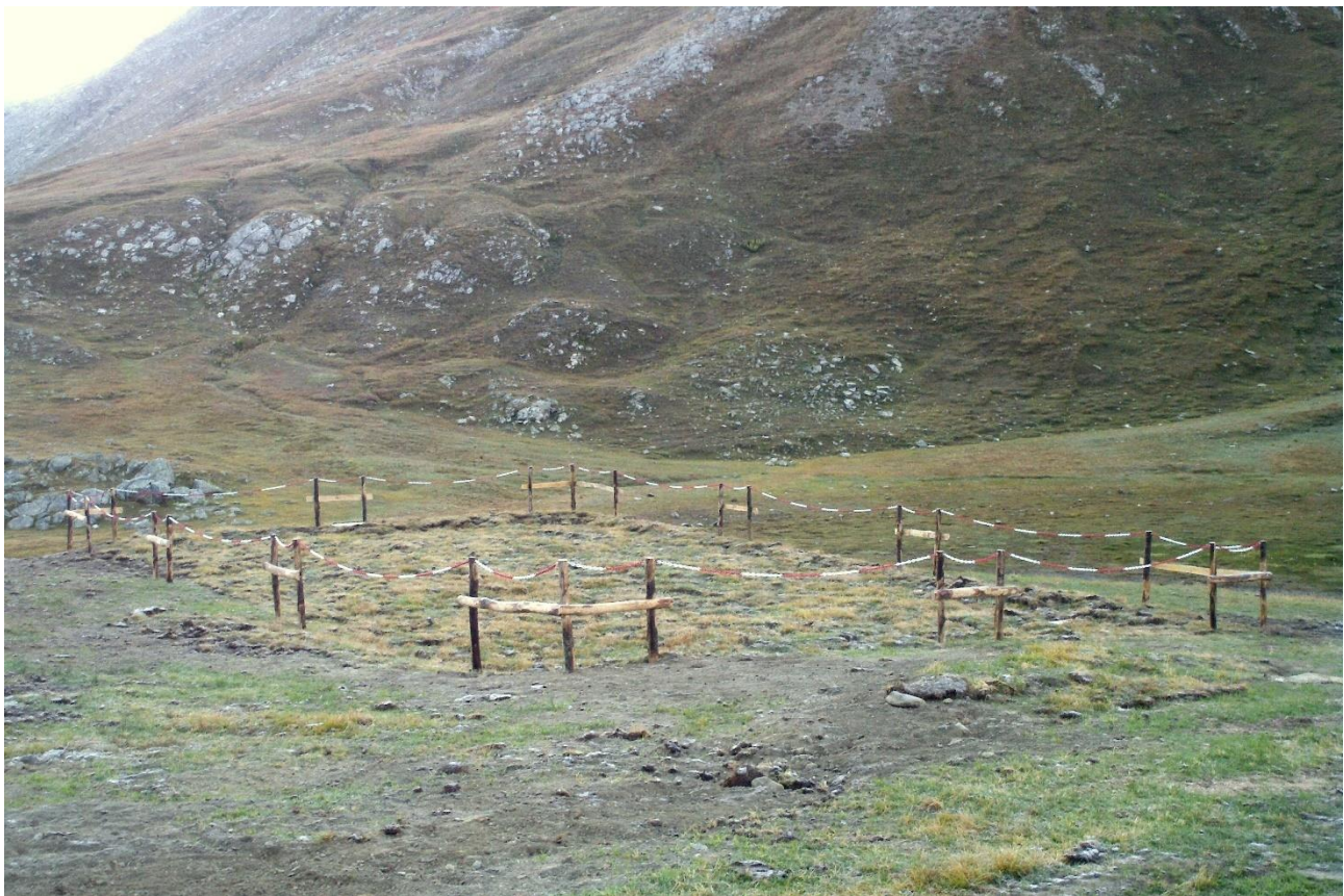
Figura 5. Impianto di pedo-fitodepurazione a servizio del Rifugio Savoia presso il Lago Nivolet (Parco del Gran Paradiso, AO)
